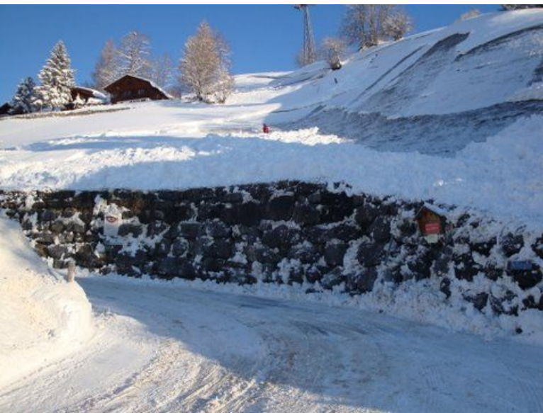
Dieser Strassenabschnitt in Hasliberg, BE (1000 m) wurde am Abend des 25.11. von einer Gleitschneelawine bis zu 4 m hoch verschüttet (Photo: W. Schaad, 26.11.2008).
