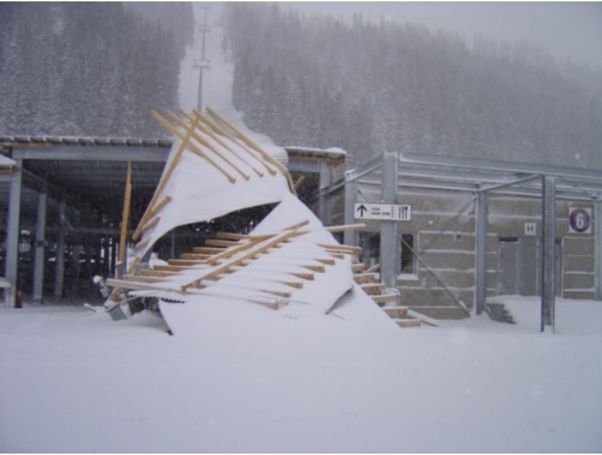
Bei einer Talstation einer Sesselbahn wurde durch den Sturm das Dach abgehoben (Foto: Thomas Wiesinger, SLF).
